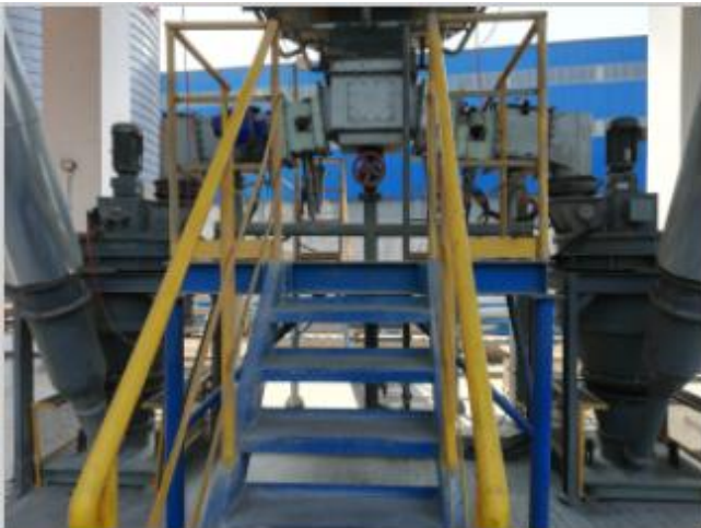
图 9 涉县金隅项目散装计量系统现场照片
